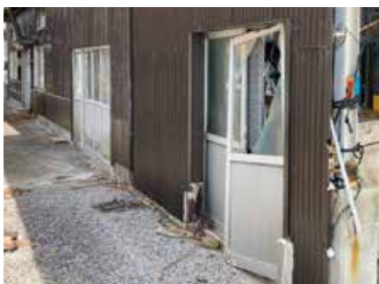
引き戸・ガラスの損傷
