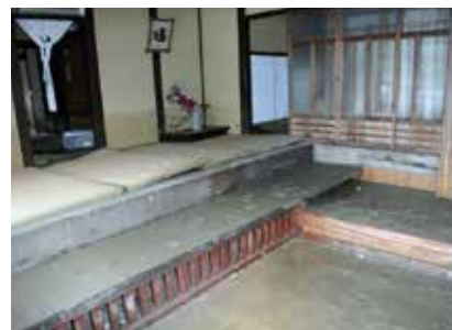
浸水被害に遭った建物
