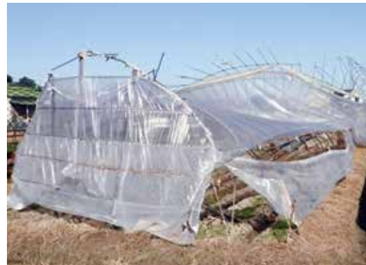
台風の被害に遭ったハウス
